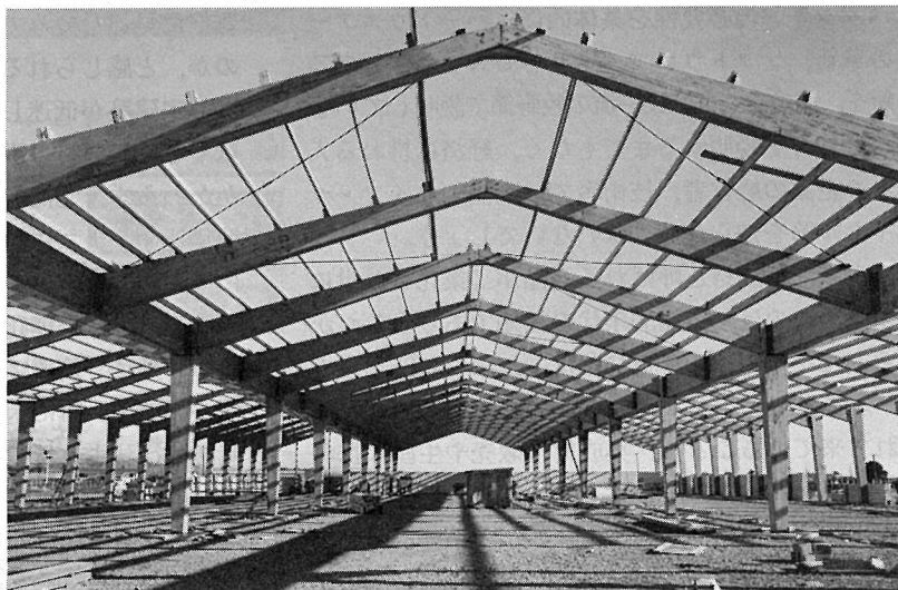
巨大な3連山形ラーメンによる倉庫（ニュージーランド・オークランド市。ニュージーランド唯一の非木質建材メーカーAHI社による……建物面積6000m 2 ）
