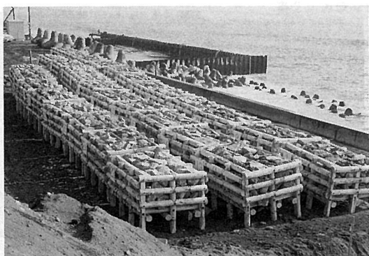
カラマツ間伐材を使った消波ブロック基礎用木工沈床 270×360×@150cm(苫小牧市)
