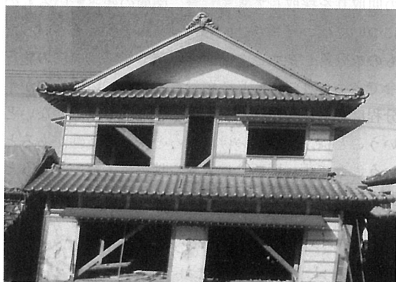
写真5 屋根が重い住宅
