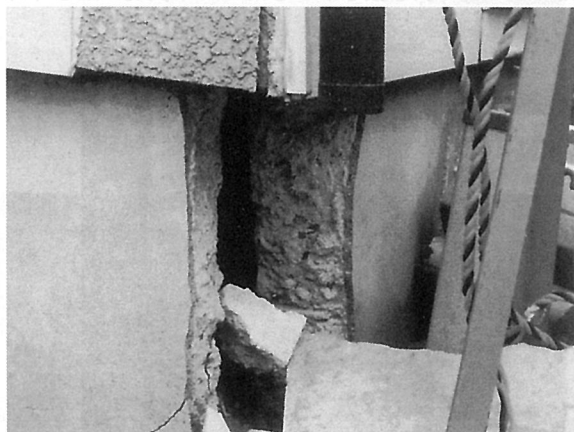
写真9 無筋布基礎の割れ
