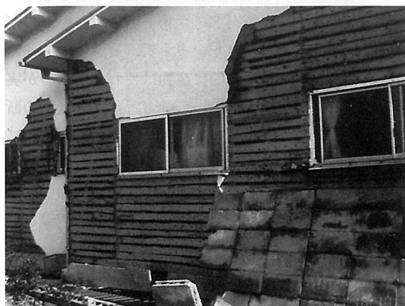
写真10 ラスモルタルの剥落
