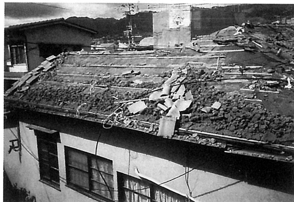
写真11 土葺き瓦屋根の被害
