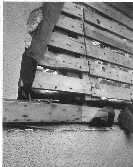
写真8 土台から抜け出た柱と筋かい
