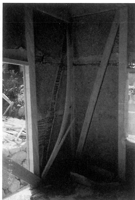
写真3 筋かいの座屈
