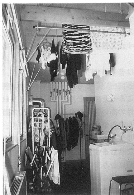
ユーティリティ土間。 ボイラー室と兼用
