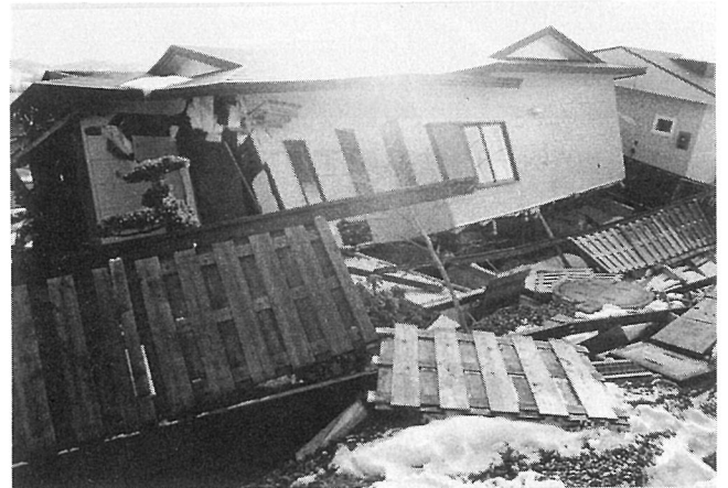
被害例—4 同、地崩れによる建物崩壊〈標茶町〉
