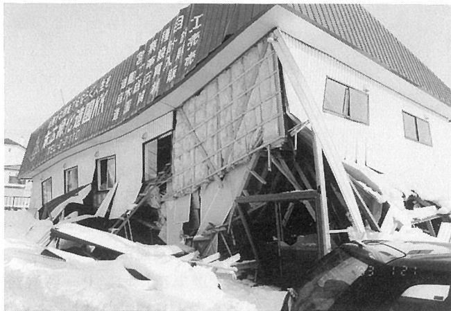
被害例—3 倉庫、2階建て〈白糠町〉
