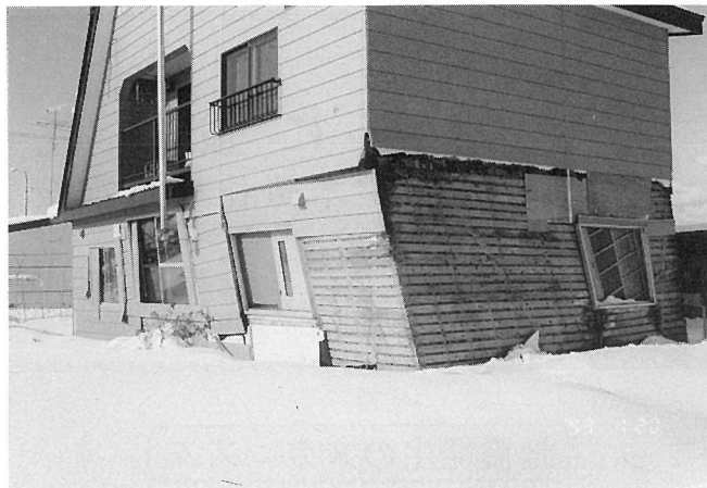
被害例一1 住宅外部〈音別町〉
