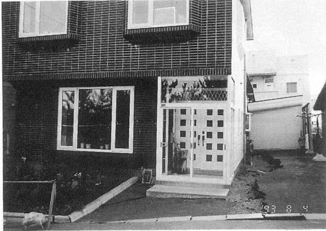
被害例一六 住宅、不同沈下〈上磯町〉
