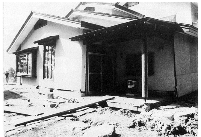
被害例—5 住宅、不同沈下〈七飯町〉
