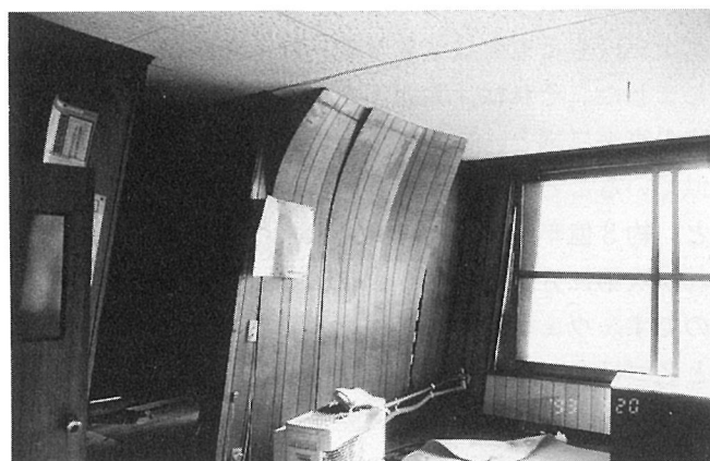
被害例一1 同，内部〈音別町〉
