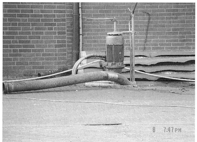
写真4 スラリーを発酵槽に送るポンプ (後ろのレンガは畜舎)
