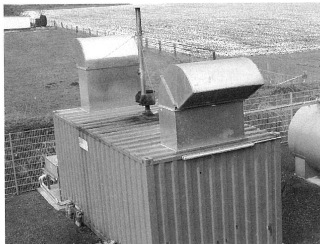
写真12 SEVA社製 CHP ユニット
