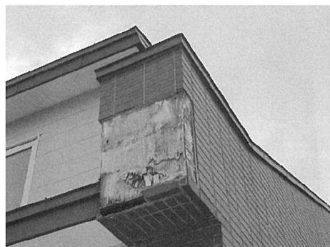
写真3 2003年十勝沖地震における木造住宅の被害 ：外装材の剥落
