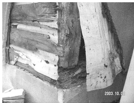
写真1 2003年十勝沖地震における木造住宅の被害 ：外装材の下地と躯体の腐朽
