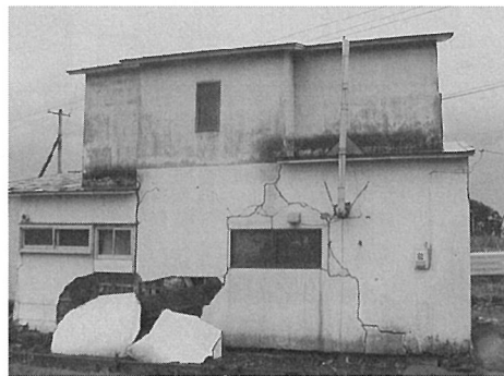
写真2 2003年十勝沖地震における木造住宅の被害 ：下地の腐朽に伴う外装材の剥離・剥落
