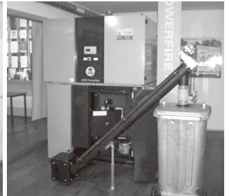
KWB社の 木質ペレットボイラー (300kw)
