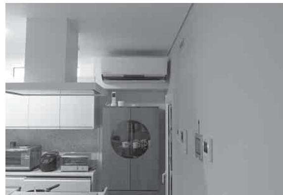
写真1 1階に設置した寒冷地用エアコン
