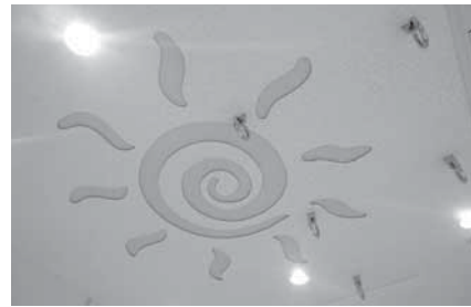
(市立稚内病院リハビリ室 天井吸音材：NCルーター加工)
