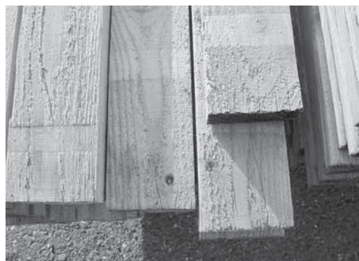
(板材の割れの状況)
