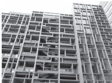
木材会館 外壁 東京都江東区新木場
