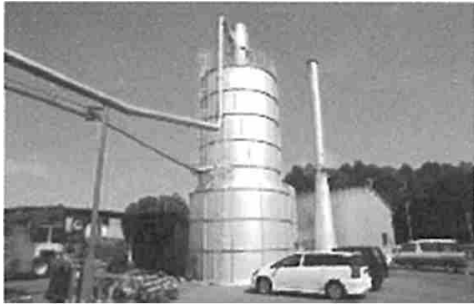
木質バイオマスボイラー
