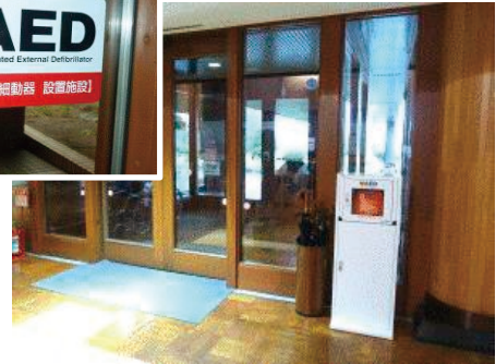
写真2 玄関横のAED設置状況
