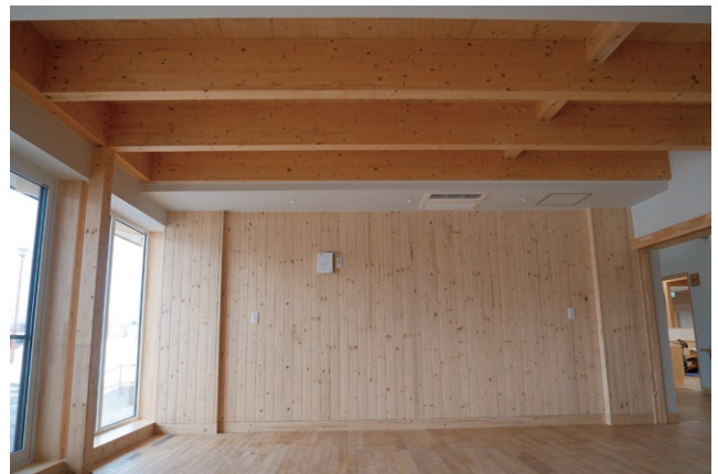
写真2 木材が現しになっている内装 (上：廊下の上部、下：保育室の壁・梁)
